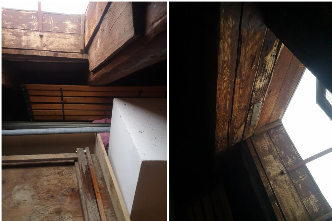
Slika 3.1: Odprto okno ob prihodu in diskoloracija lesene obloge pri oknu.
