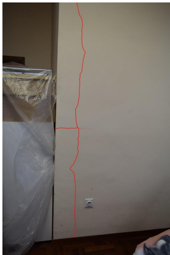
Slika 3.21: Soba 4 - navpična razpoka na stiku predelnih sten, vgrajenih med prenovo l. 1992.
