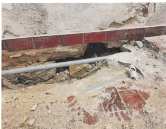
Slika 10: Neustrezno sanirana odprtina v zidu, ki je nastala ob prebijanju za izvedbo odtočne cevi. S-2, 17. 1. 2024 (fotoarhiv 44685d-46)
