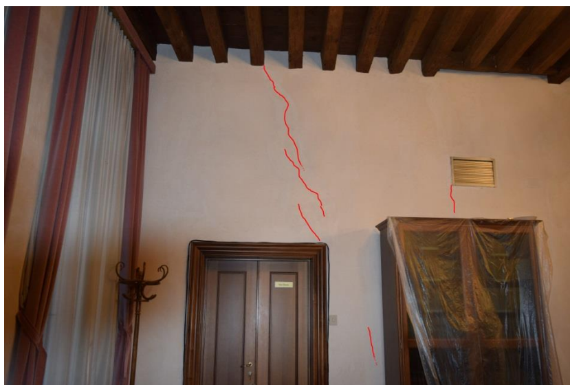
Slika 3.27: Slavnostna dvorana v 1. nadstropju - razpoke v območju vratne odprtine v nosilnem zidu med dvorano in Dantejevo sejno sobo.
