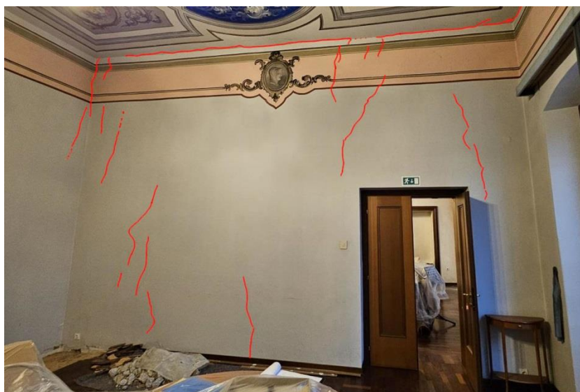
Slika 3.28: Dantejeva sejna soba v 1. nadstropju - razpoke v nosilnem zidu med tem prostorom in Slavnostno dvorano, razpoke tudi na stiku s stropom.
