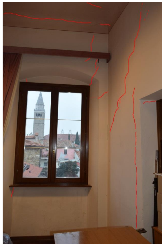
Slika 3.11: SV vogal - strma poševna in navpična razpoka na robu zidanega nadokenskega loka.
