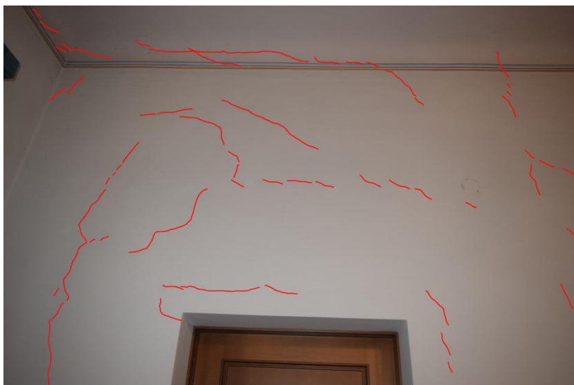
Slika 3.19 (levo): Poševne razpoke levo od vrtnice odprtine in nad odprtino v nosilnem zidu med Sobo 2 in Sobo 3.
