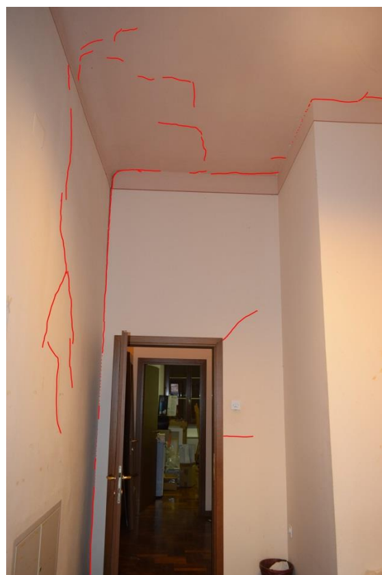
Slika 3.14: Razpoke na stiku med nosilnim zidom na levi strani in predelno steno in razpoke v predelnih stenah.
