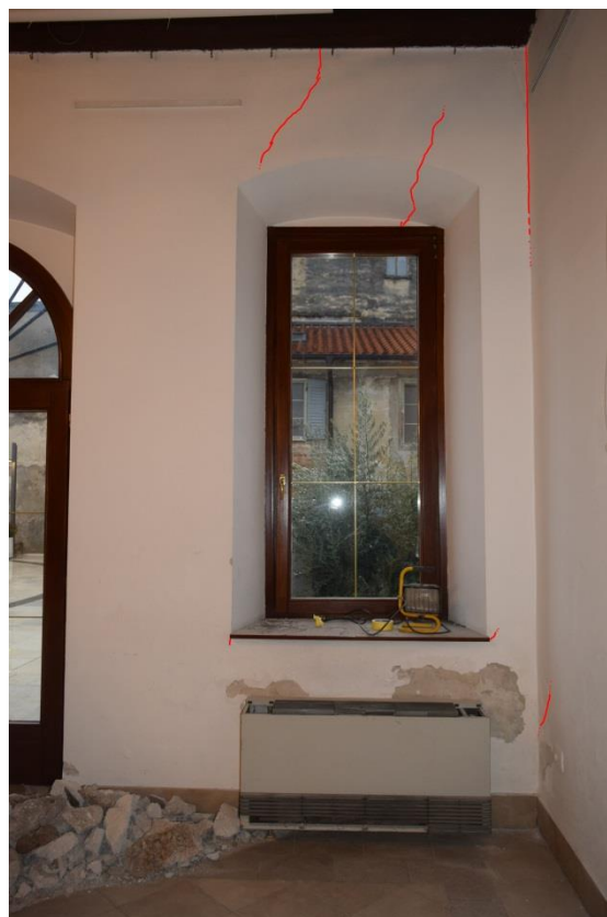
Slika 3.40: Razpoke v nadokenskem slopu v južnem zidu, ob zahodnem zidu. Na vrhu je prisotna tudi navpična razpoka na stiku južnega in zahodnega zidu. Spodnji del južnega in zahodnega zidu pa sta prekomerno navlažena.
