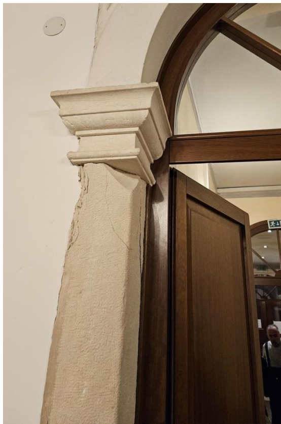
Slika 3.43: Levi steber kamnitega portala na prehodu iz avle v stopnišče je v zgornjem delu, pod kapitelom, delno porušen.
