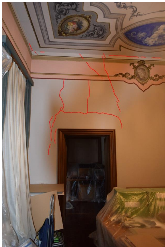
Slika 3.29 (levo): Dantejeva sejna soba v 1. nadstropju - razpoke v nosilnem zidu med to sobo in Manjšim salonom, v območju vratne odprtine in na stikih.
