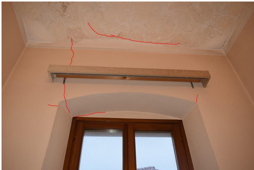
Slika 3.30: Manjši salon v 1. nadstropju - razpoke v območju nadokenskega slopa in stika severnega zidu s stropom.
