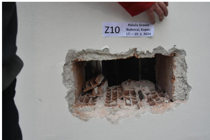
Slika 4.33: Detajlni pogled na mesto Z10 po odstranitvi opečnega votlaka.
