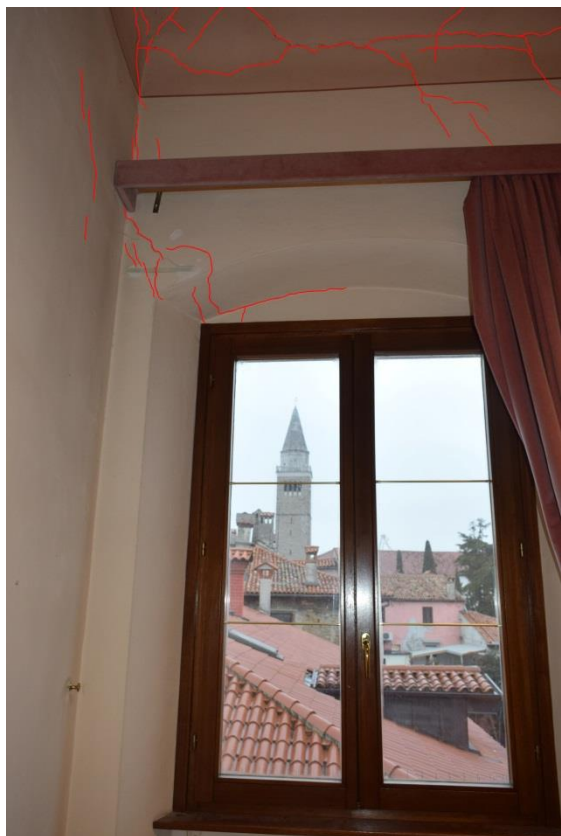
Slika 3.8 SZ vogal - do 2.0 mm široke prečne in poševne razpoke v nadokenskem slopu, ki se navzgor nadaljujejo v navpično razpoko na stiku med zahodnimi in severnim zidom.
