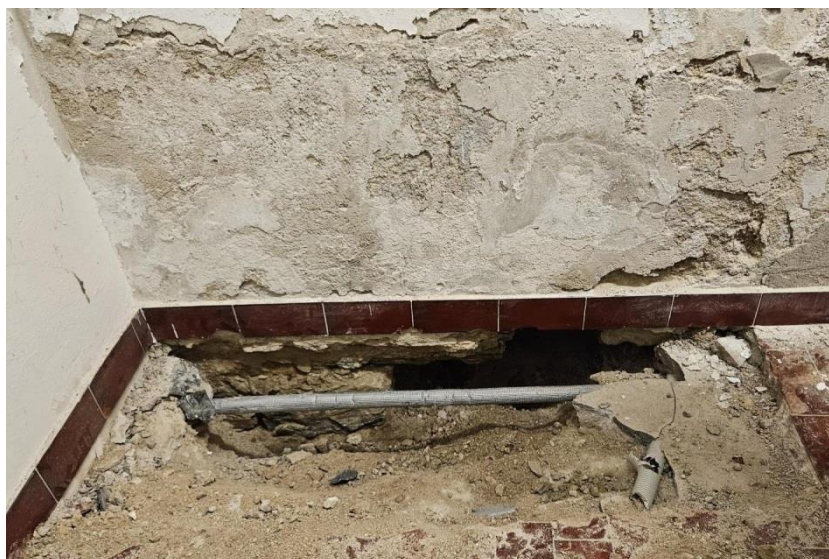
Slika 3.44: Pritličje, Klet - posledice prekomerne navlaženosti v notranjem kletnem zidu med Kletjo in Garderobo.
