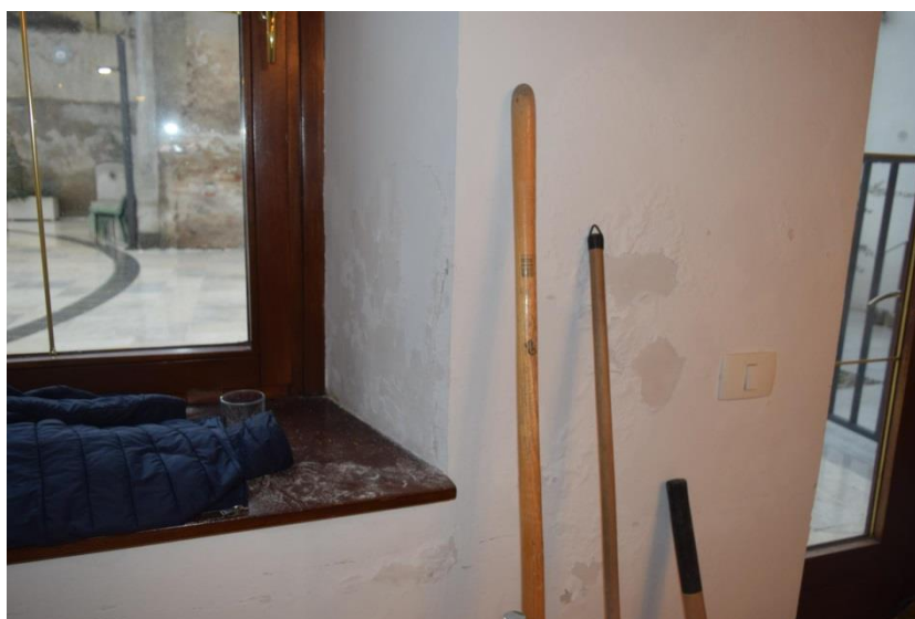
Slika 3.41: Na površini parapeta pod oknom in slopa med oknom in vrati v južnem zidu so prav tako vidne posledice prekomerne navlaženosti.
