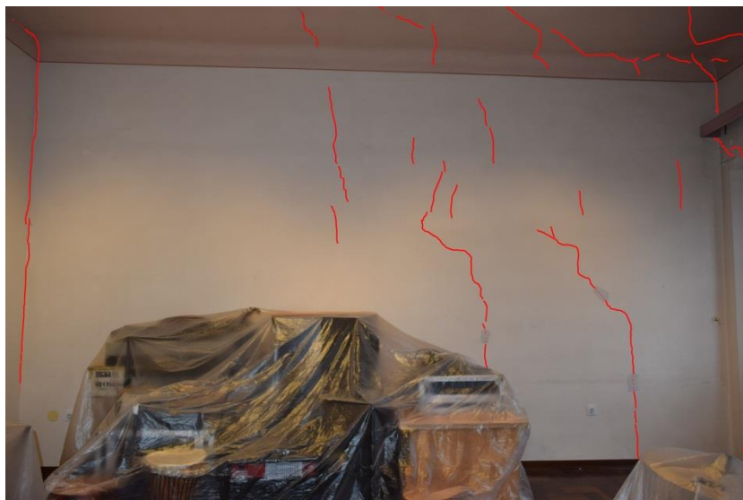
Slika 3.12: Razpoke v zahodnem zunanem zidu, zlasti v območju prvotnih in zazidanih okenskih odprtin, razpoke na stiku med zahodnim in severnim zidom, med zidom in stropom ter na stiku med predelno steno (na levi strani) in nosilnim zahodnim zidom.
