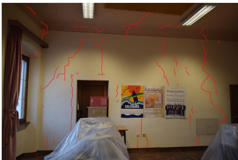
Slika 3.13: Razpoke v notranjem vzdolžnem zidu, zlasti v območju vratne odprtine.
