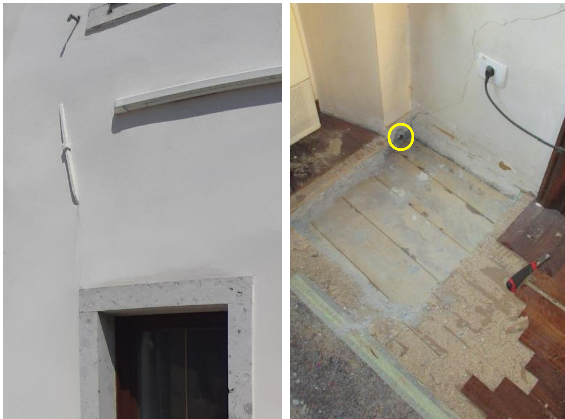
Sliki 4.47 in 4.48: Ključ prvotne vezi na južnem pročelju in mesto vstopne odprtine prvotne vezi tik ob zidu in tik nad deskami lesene stropne konstrukcije nad vhodno avlo (obkroženo z rumeno).
