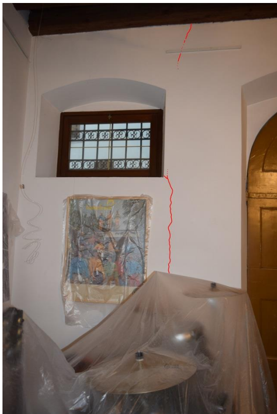
Slika 3.42: V nadokenskem slopu v severnem zidu vidna le zelo tanka razpoka, nekoliko širša pa poteka ob robu parapetnega dela zidu.
