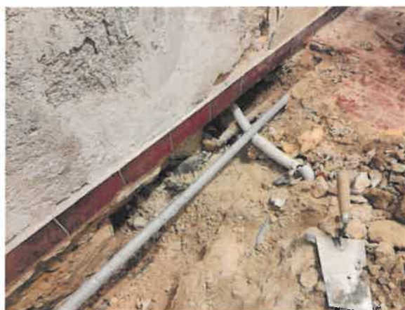
Slika 11: Vidna prekinjena vodovodna cev. S-2, 17. 1. 2024 (fotoarhiv 44685d-46)
