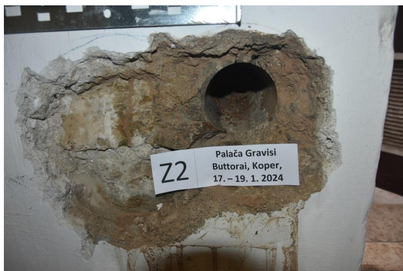
Slika 4.9: Pregledno mesto Z2 v kurilnici.
