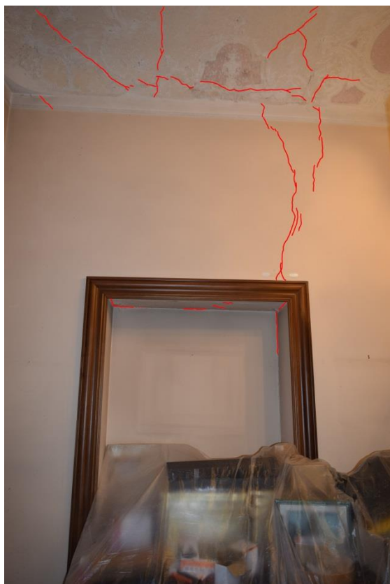
Slika 3.33: Razpoke v vzhodnem zidu, nad zidno nišo, in razpoke v stropnem ometu.
