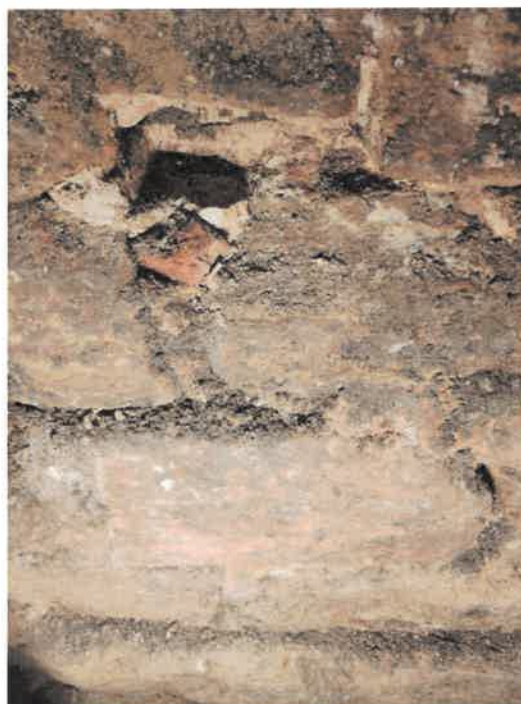
Slika 6: Po odstranitvi opeke, ni vidne injekcijske mase. Izkop S-1, 17. 1. 2024 (fotoarhiv 47761d-16)
