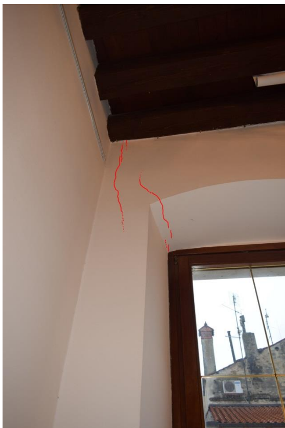
Slika 3.39: Razpoke na robu nadokenskega slopa v južnem zidu, ob notranjem zidu.
