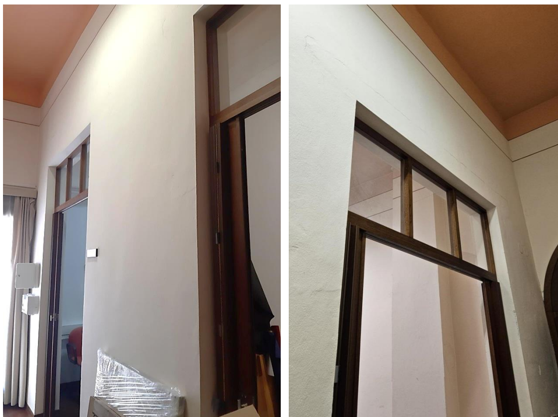
Sliki 2.21 in 2.22: Hodnik v 1. nadstropju - nosilni zid med hodnikom in prostorom administracije ni bil nadomeščen z a.b. stebrom, kot predvideno v projektu (sliki 2.10 in 2.11), ampak je bil na delu ohranjen, na delih porušen za povečanje obstoječe oziroma izvedbe nove odprtine.
